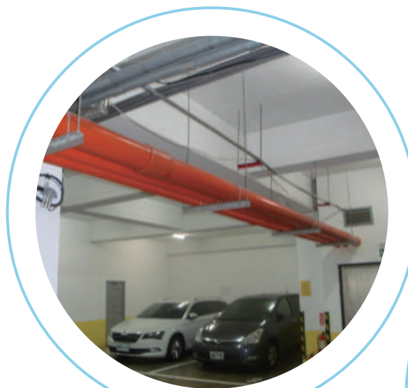
大樓污水管與污水下水道連結
