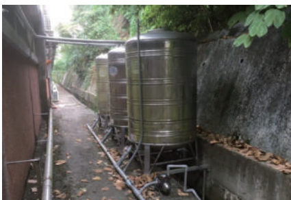
空調冷凝水回收
