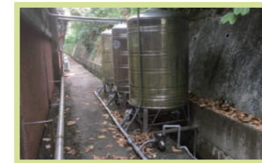
空調冷凝水回收
