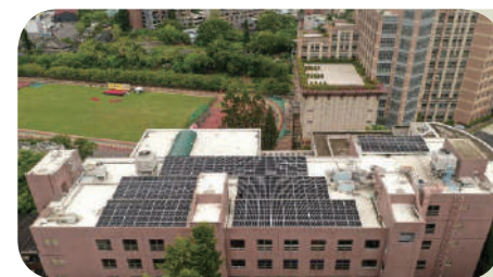
太陽光電發電設備 (雙溪校區)
