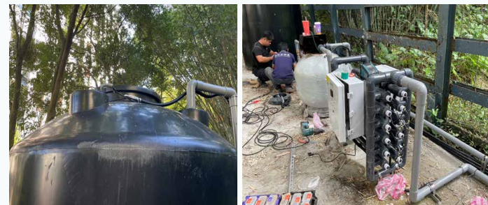
沉砂池水抽蓄處理系統
